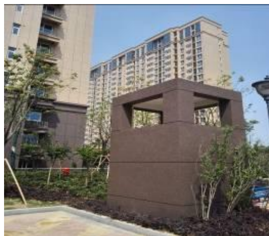
地下车库排风口
