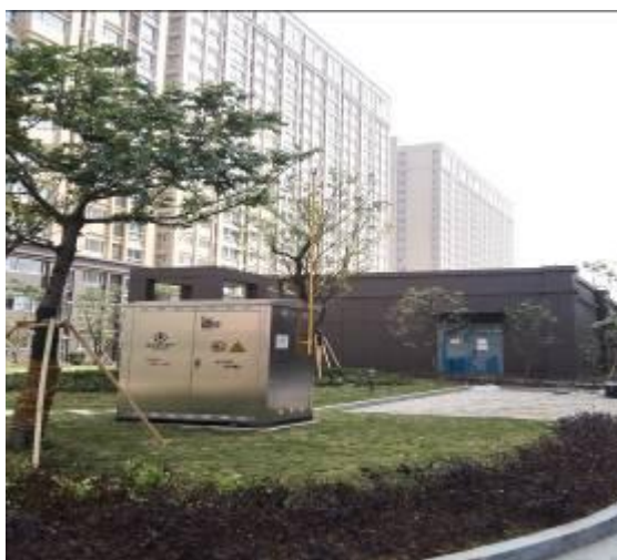
天然气调压站
